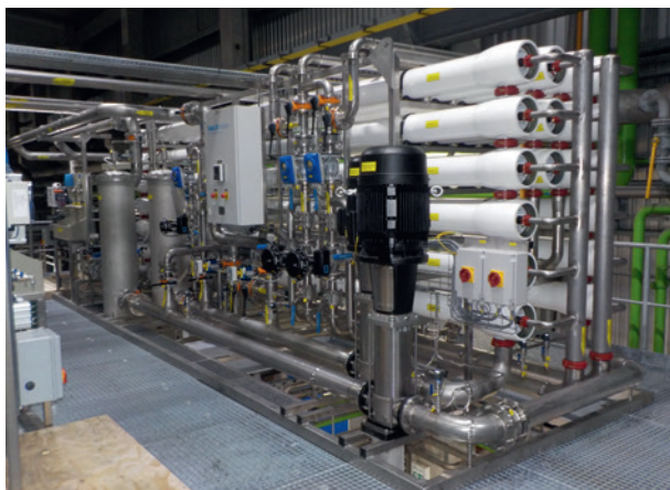
Neue Wasseraufbereitung mit Umkehrosmose-Modulen
